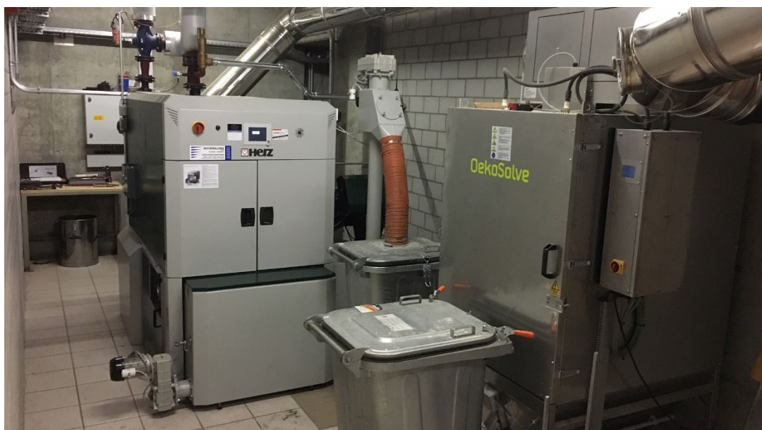
Production de chaleur 300 kW CAD Vicques
