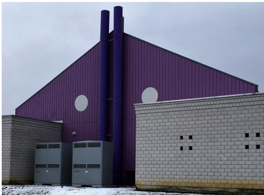
PAC air/eau de la salle des fêtes de Courtételle
