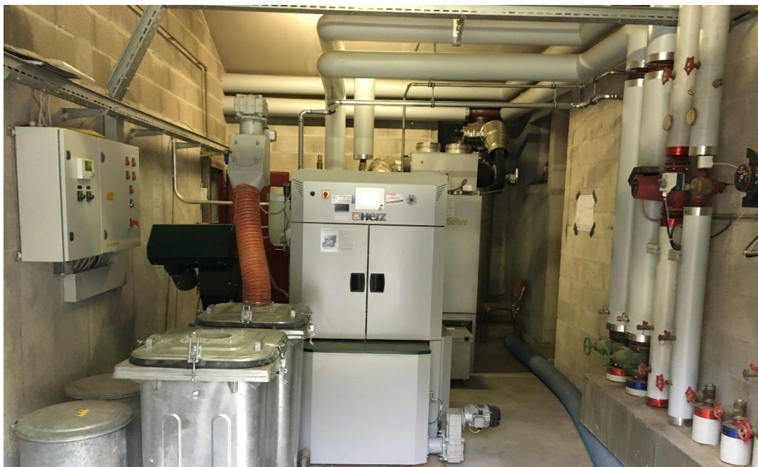
Production de chaleur 150 kW CAD Vermes
